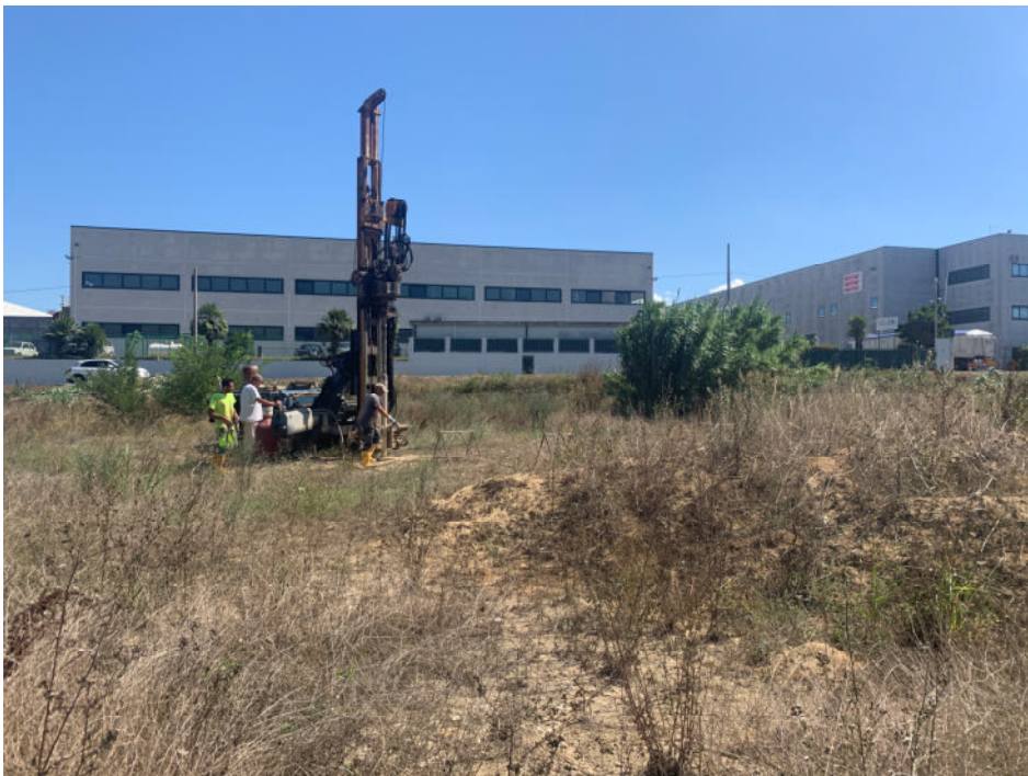
FOTO 2: Ubicazione piezometro PZD3 sul cumulo di materiale proveniente da terre e rocce da scavo.
